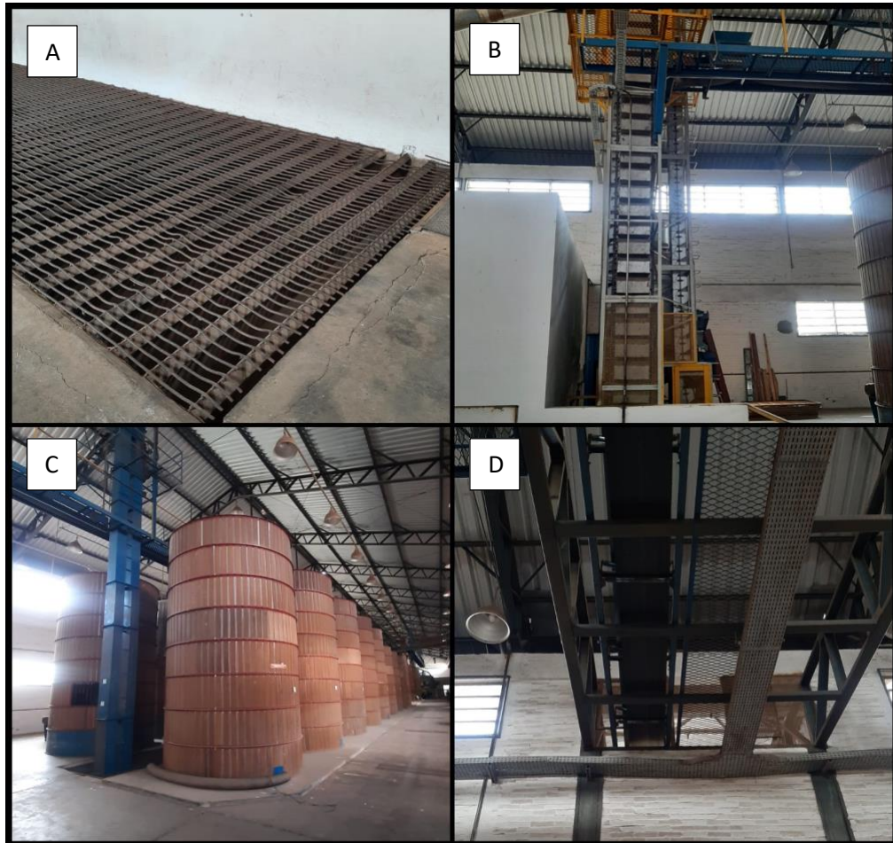
Figura 23 – Etapas de recebimento das sementes na UBS a) Moega, b) Elevadores responsáveis por levar as sementes até os silos, c) Silos de armazenagem, d) Esteiras que transportam as sementes até a etapa de beneficiamento
