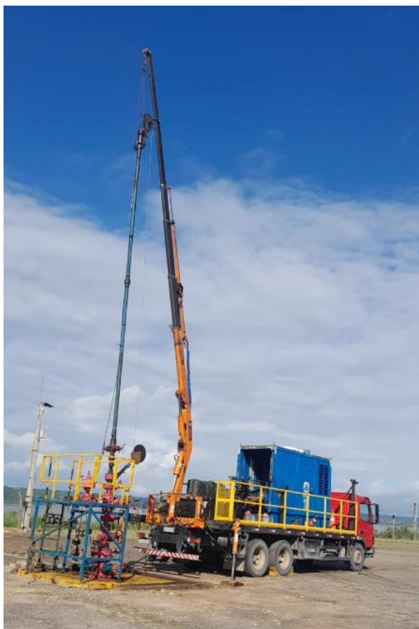
Figura D1 – Unidade de slickline posicionada em um poço onshore.
