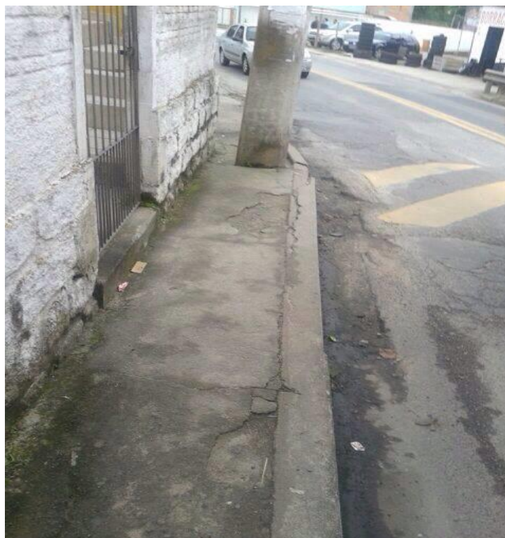
Figura 12 – Calçada irregular/ Córrego Grande Fonte: arquivos da autora – junho de 2015
